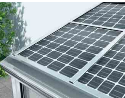
Energiegewinn: Wintergarten mit BIPV
